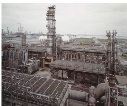
水を使わず、大気で冷却 空冷式熱交換器 Air-cooled heat exchanger
